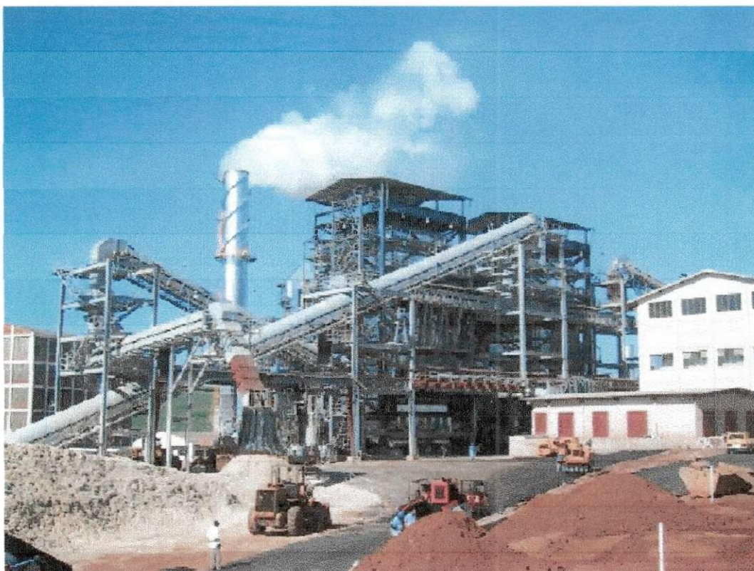
Figura 11 - Vista de um Conjunto de duas Caldeiras DEDINI em Usina de Açúcar e Álcool de 175 t/h de Vapor a 62 bar e 500 °C cada uma
