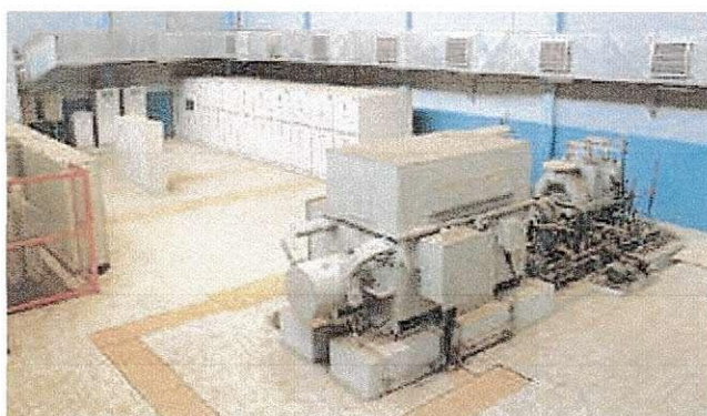
Figura 5 - Casa de Força do Sistema de Cogeração de uma Usina de Açúcar
