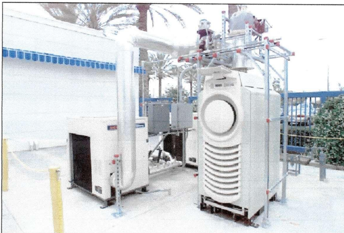
Figura 15 - Unidade de Cogeração Eletricidade e Água Gelada por Absorção Capstone de 30 kWe
