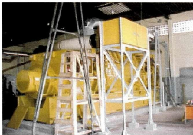
Grupo Gerador Caterpillar de 2.000 kW – UTE Parintins
