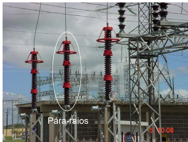
Fig. 1 - Exemplo da instalação de um para-raio de ZnO
