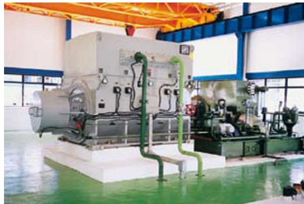
Figura 3 – Turbo Gerador a gás [7].
