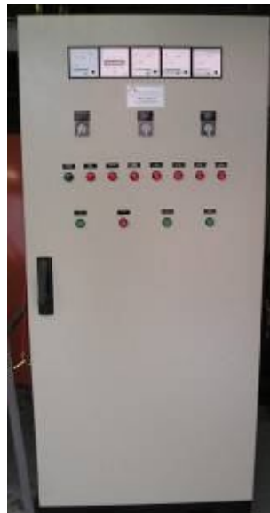
Figura 18 – Quadro de comando [20] .
