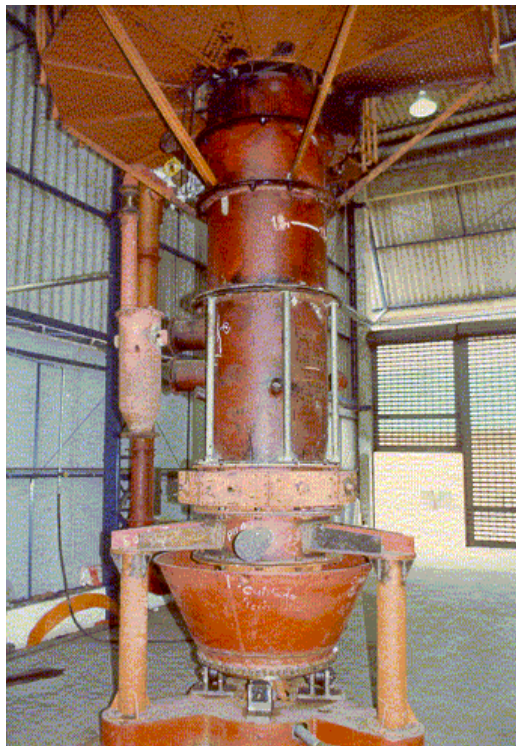
Figura 5.4 - Gaseificador de Leito Fixo Instalado no IPT, (Cenbio, 2001).
