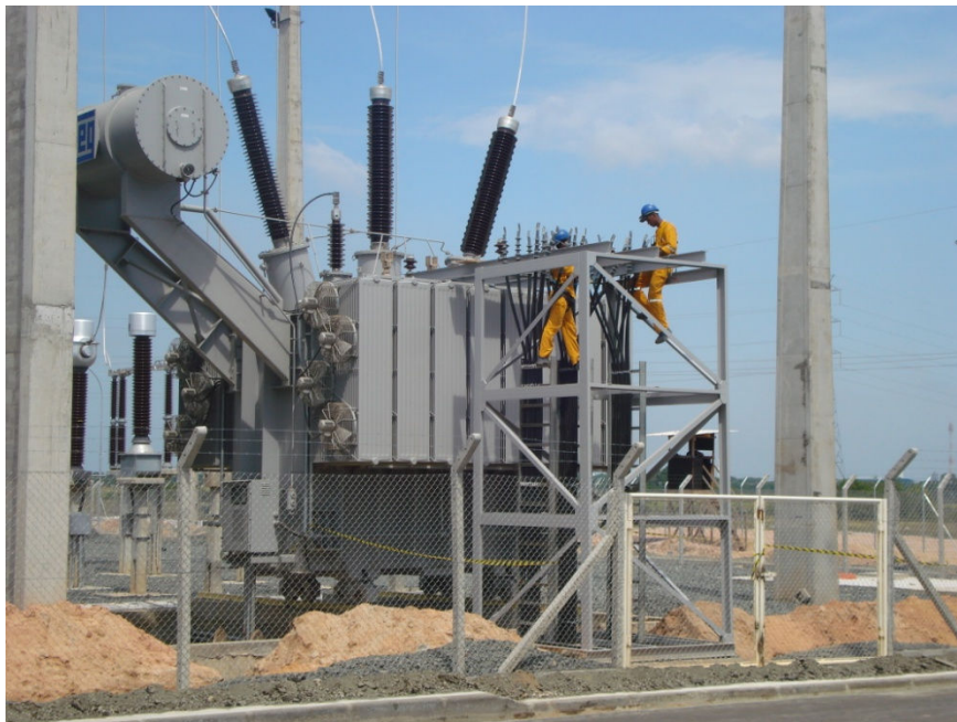
Figura 4.1 – Transformador Elevador 80/95 MVA – SE UTE Muricy I
