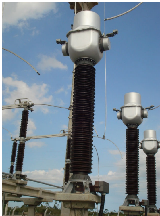
Figura 4.3 – Transformadores de Corrente – SE UTE Muricy I
