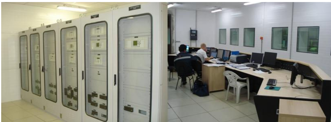
Figura 5.1 – Sala de Controle UTE Muricy I e Painéis de Proteção da Subestação
