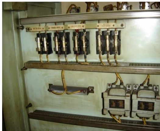
Figura 3.1.2.2.11 - Vista Interna Transformadores de Potência e Proteção
