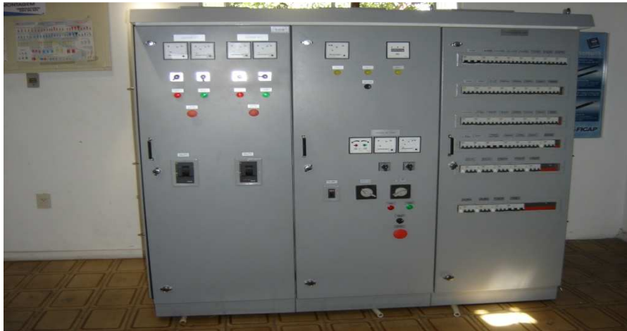
Figura 3.1.2.2.30 - Painel Elétrico Rebocador Jatobá
