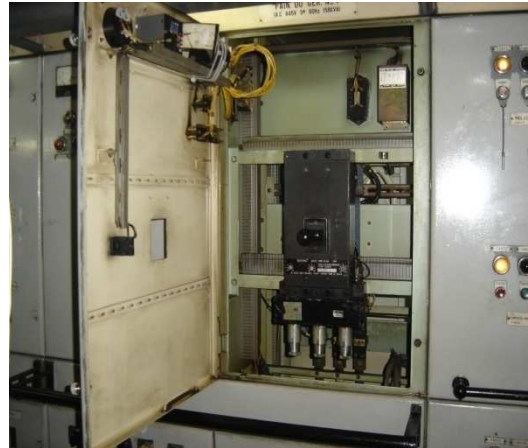
Figura 3.1.2.2.5- Vista Interna Painel Ger. Boreste
