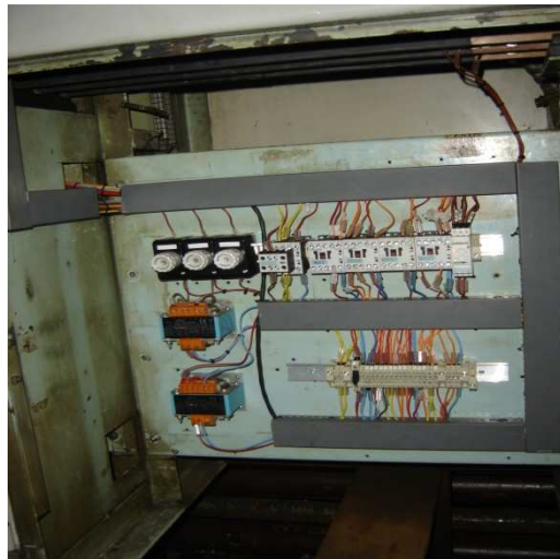
Figura 3.1.2.2.17 - Vista Interna Painel Gerador Boreste
