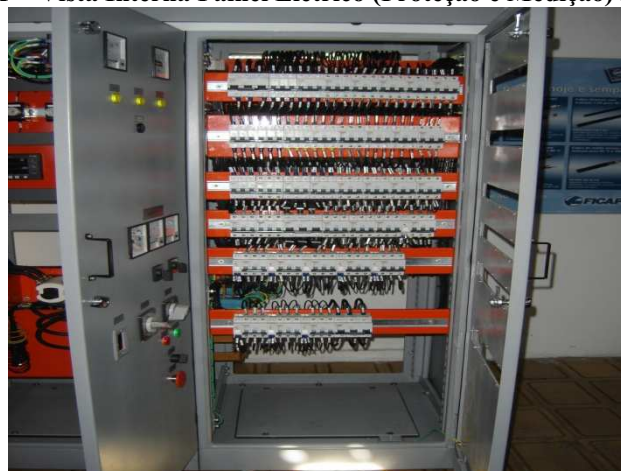
Figura 3.1.2.2.32 - Vista Interna Painel Elétrico (Distribuição) Rebocador Jatobá
