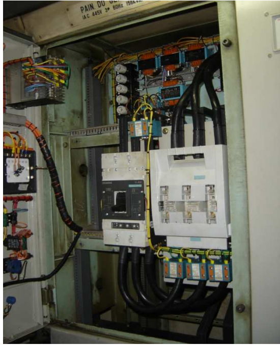
Figura 3.1.2.2.16 - Vista Interna Painel Gerador Bombordo
