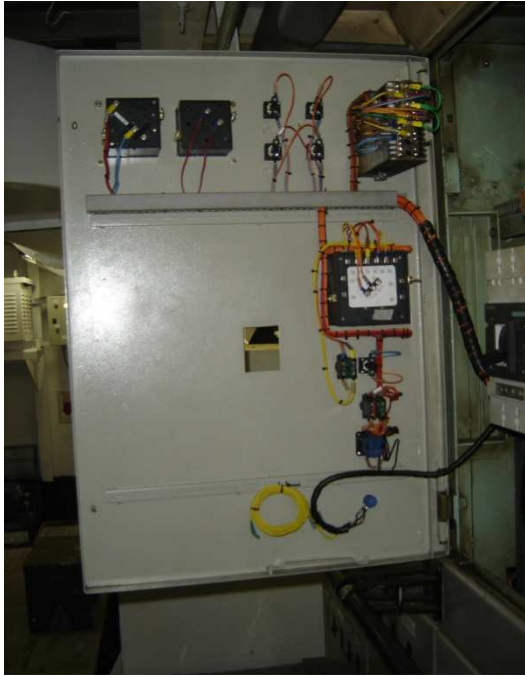
Figura 3.1.2.2.15 - Vista Interna Painel Gerador Bombordo
