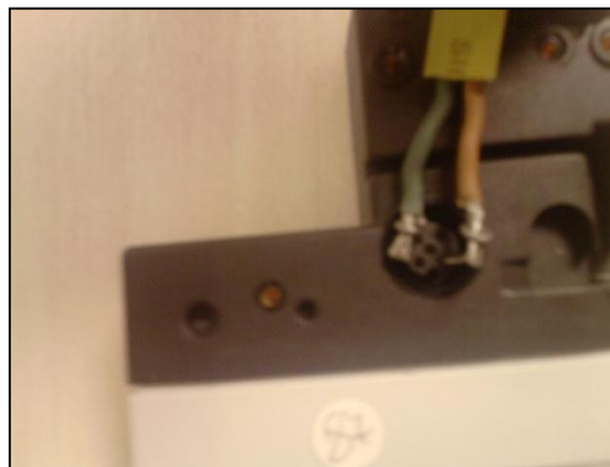
Figura 6.18 – Foto da conexão do escravo AS-i com o dispositivo endereçador – vista dos conectores.
