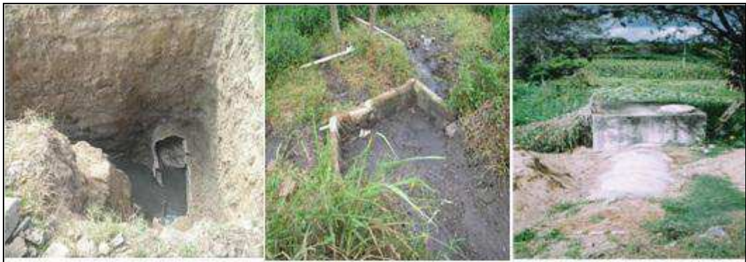
Figura 9 – Fotos de Intervenção nos Emissários, várias formas de desvios de esgotos sanitários, Campina Grande PB.
