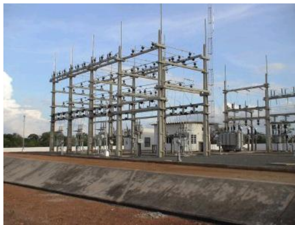
Figura 12 – SE Abaixadora - rebaixando de 69 kV para 34,5 kV. Fonte: Eletrobras – Governador Inaugura uma Nova Subestação em Uruçuí, 2011.
