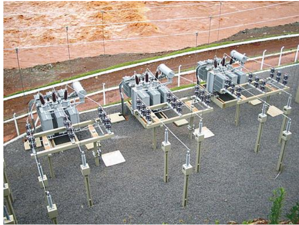
Figura 11 – SE Elevadora – aumentando de 6,6 kV para 69 kV. Fonte: Ceriluz – Usina José Barasuol, 2011.
