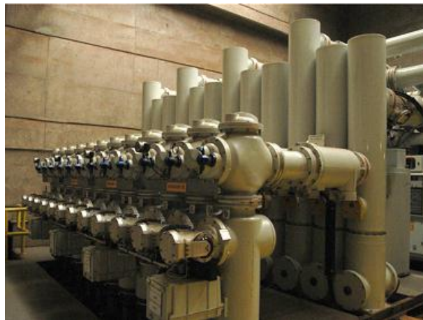
Figura 17 - SE Blindada a Gás SF 6 .
