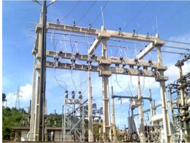
Figura 13 – SE de Distribuição.
