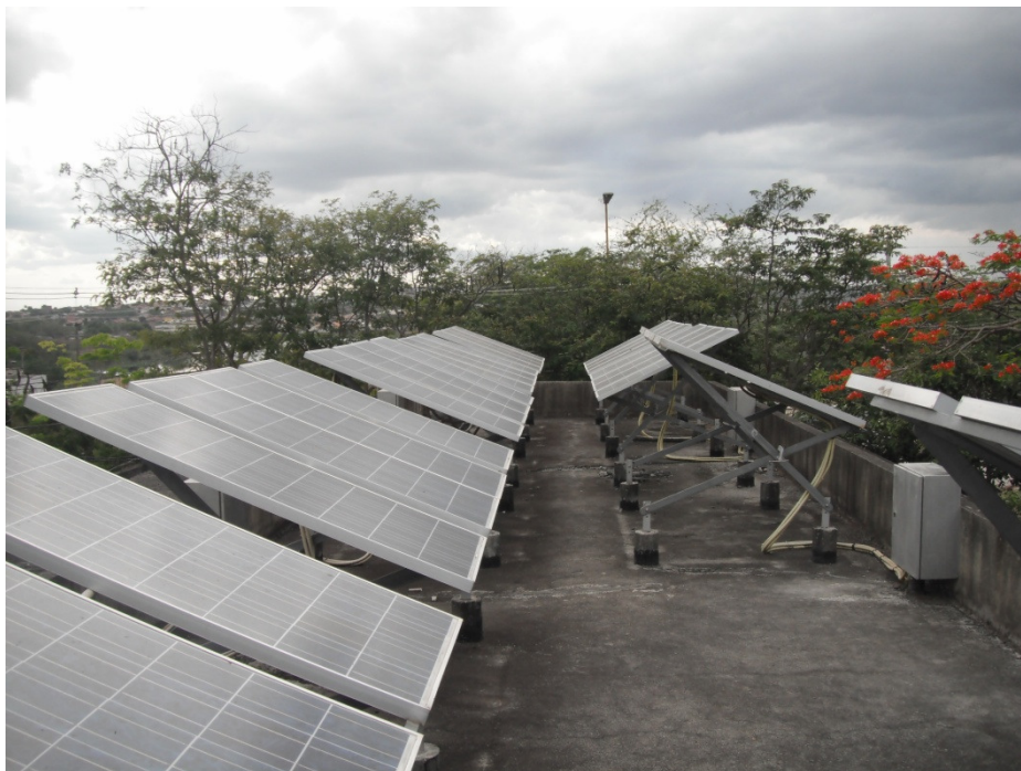
Figura 8 - Conjunto de painéis fotovoltaicos instalado na laje do LEIAM
