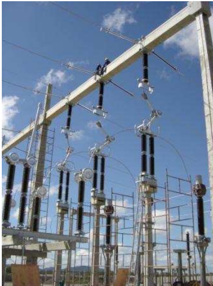
Figura 35 - Fotografia da chave seccionadora tipo semi pantográfica instalada na SE CTM.
