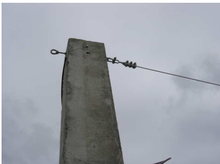
Figura 18 - Fotografia do cabo pára-raios conectado à estrutura.
