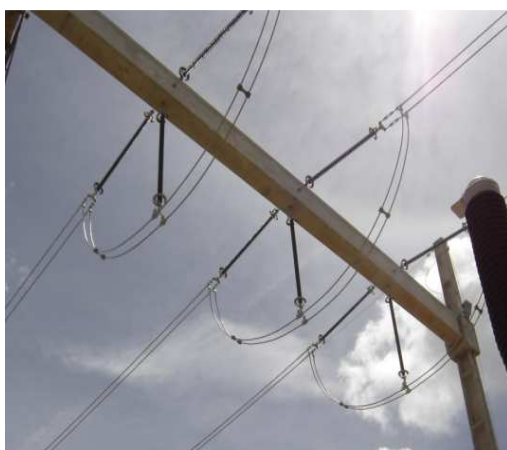
Figura 10 - By-pass no setor 230 kV.
