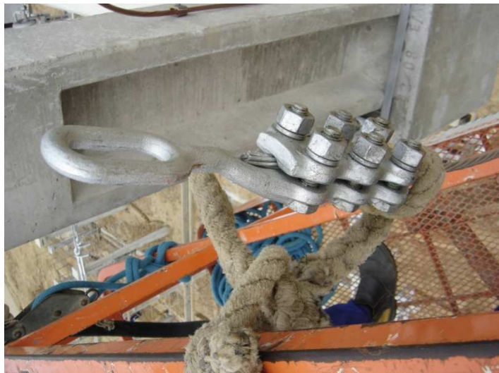
Figura 17 – Fotografia do grampo tensor para conexão do cabo à estrutura.
