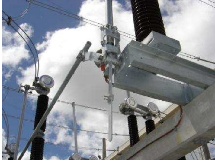
Figura 32 - Fotografia do ponto destinado à conexão da lâmina de terra.
