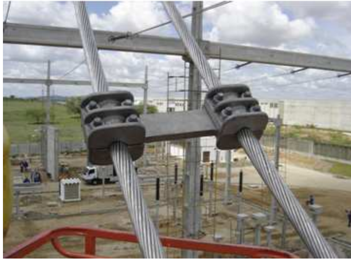
Figura 14 – Fotografia dos espaçadores de cabos em aço forjado – setor 230 kV.
