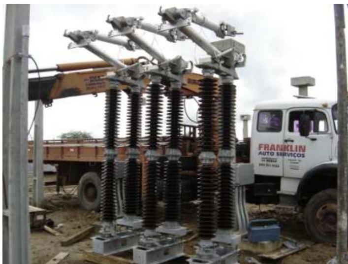
Figura 39 - Fotografia do conjunto inferior dos seccionadores semi pantográficos.
