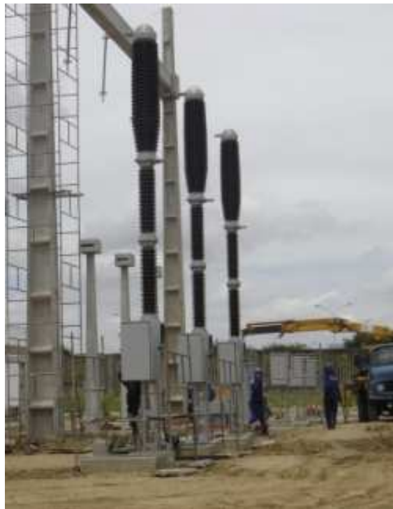
Figura 20 - Fotografia de um disjuntor de três pólos instalado na SE CTM.
