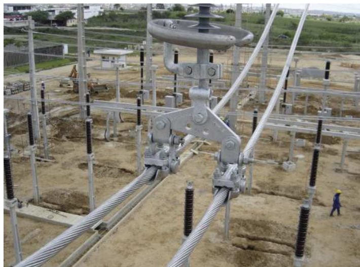
Figura 13 – Fotografia do grampo de suspensão articulado em liga de alumínio - setor 230 kV.
