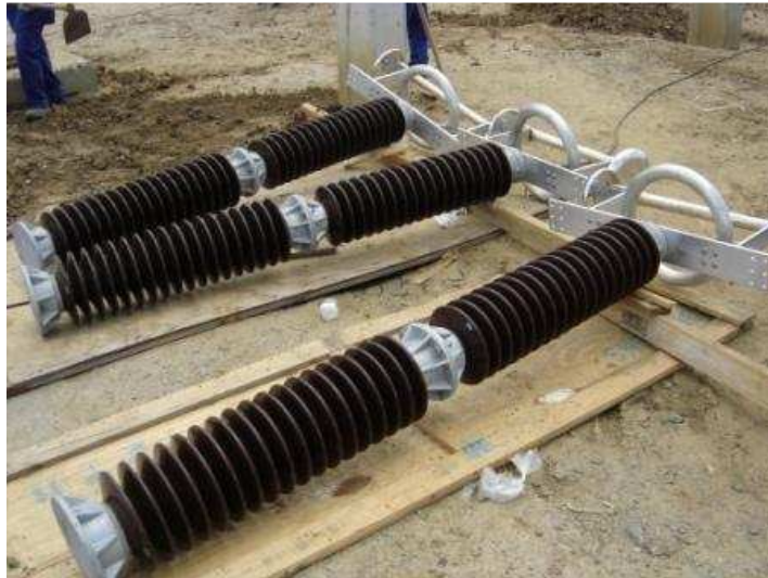
Figura 38 - Fotografia do conjunto superior dos seccionadores semi pantográficos.
