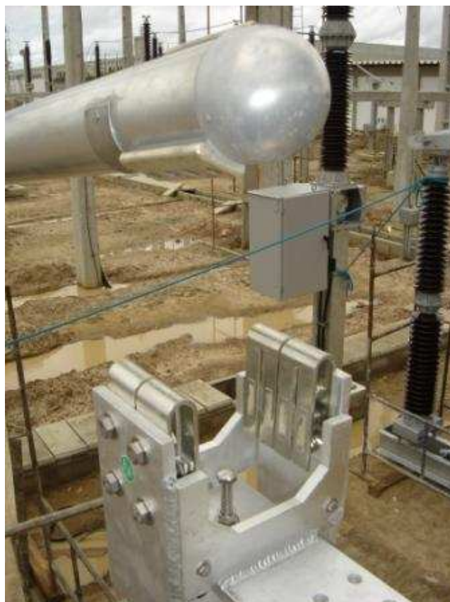
Figura 31 - Fotografia do contato principal da chave seccionadora de abertura vertical.
