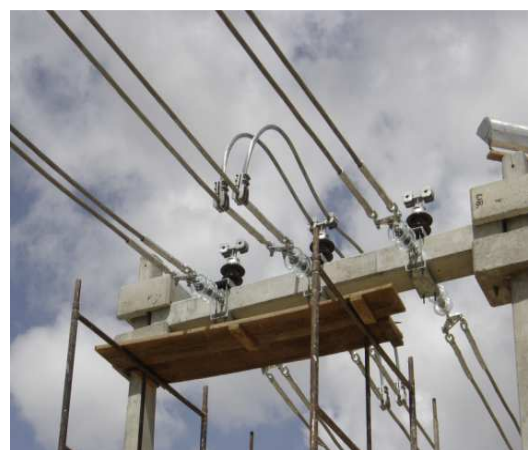
Figura 11 - By-pass no setor 13,8 kV.
