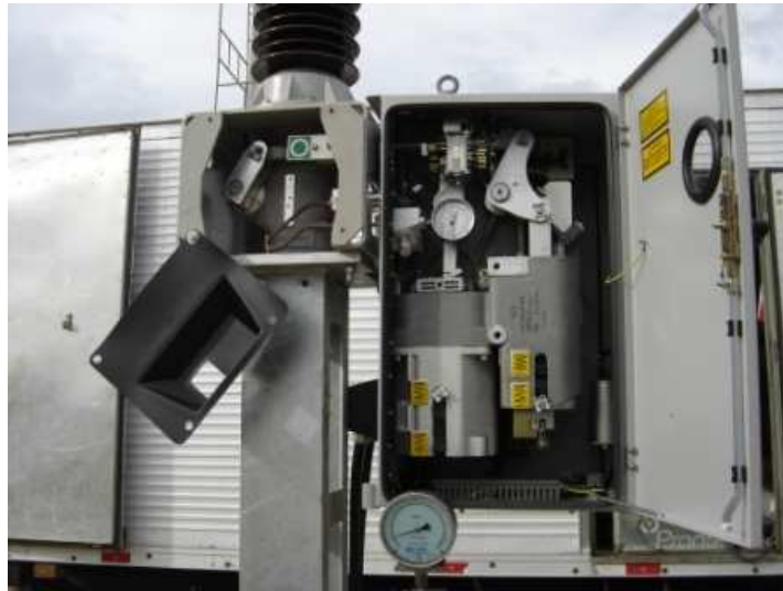
Figura 21 - Fotografia do cubículo de acionamento de um dos pólos do disjuntor.
