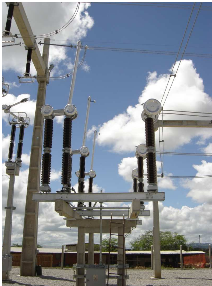
Figura 34 - Fotografia do seccionador EVL sem LT instalado na SE CTM.
