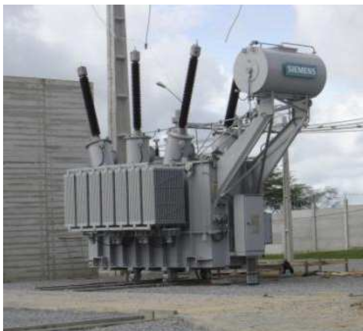
Figura 47 - Fotografia do transformador instalado na SE CTM.
