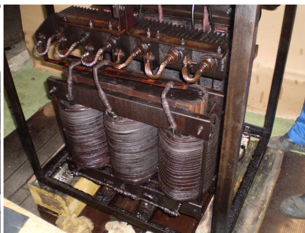
Figura 31-Retificador aberto, para detecção de defeitos.
