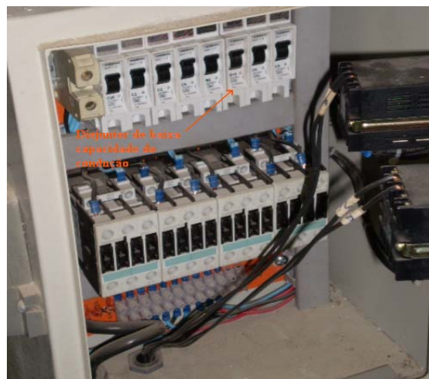
Figura 11-Painel de alimentação e controle de temperatura da mesa
