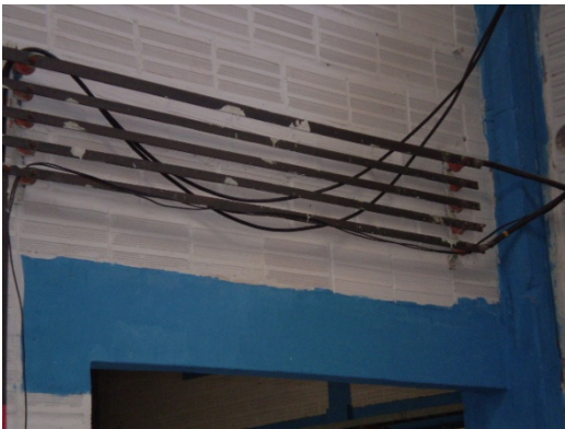
Figura 32-Barramentos expostos ao meio ambiente
