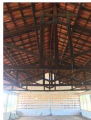
b. Interior da instalação
