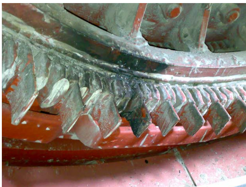
Figura 10. Fotografia da bobina do motor principal do moinho de cimento danificada.
