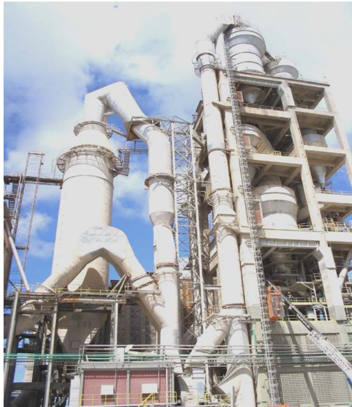
Figura 6. Fotografia da Torre de Ciclones.
