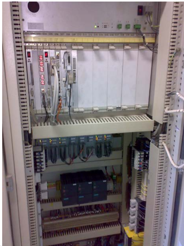
Figura 12. Fotografia do painel do inversor de frequência Siemens.
