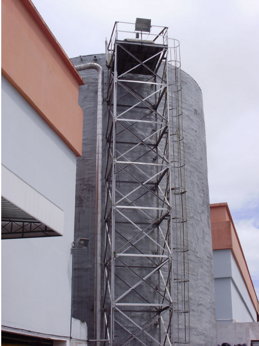
Figura 3 - Tanque de água gelada
