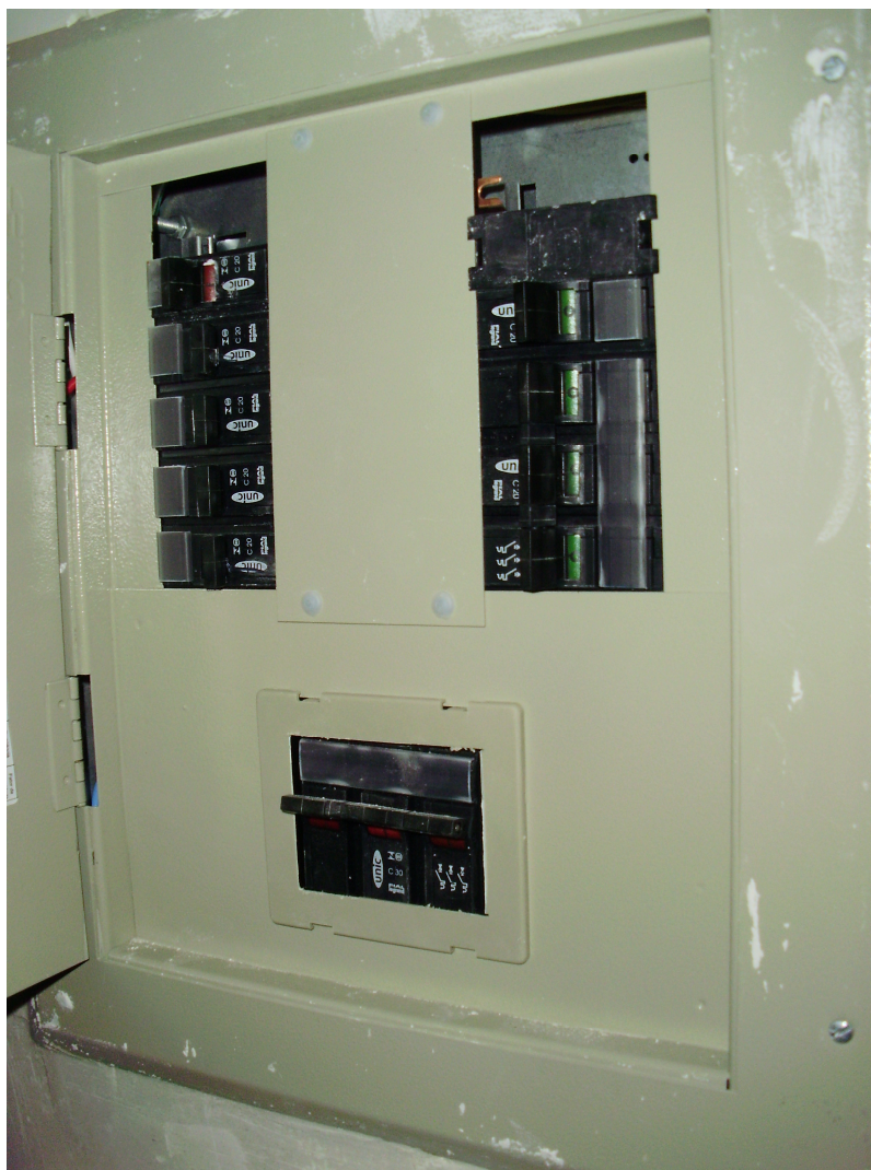
Figura 6 - Quadro de distribuição de energia elétrica em construção em uma das novas instalações
