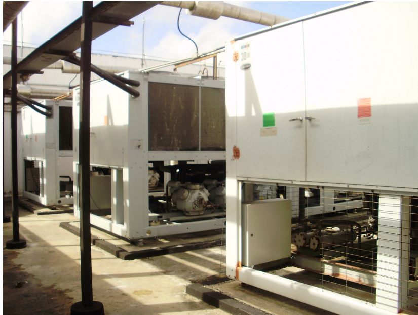
Figura 2 - Unidades resfriadoras do tipo chiller
