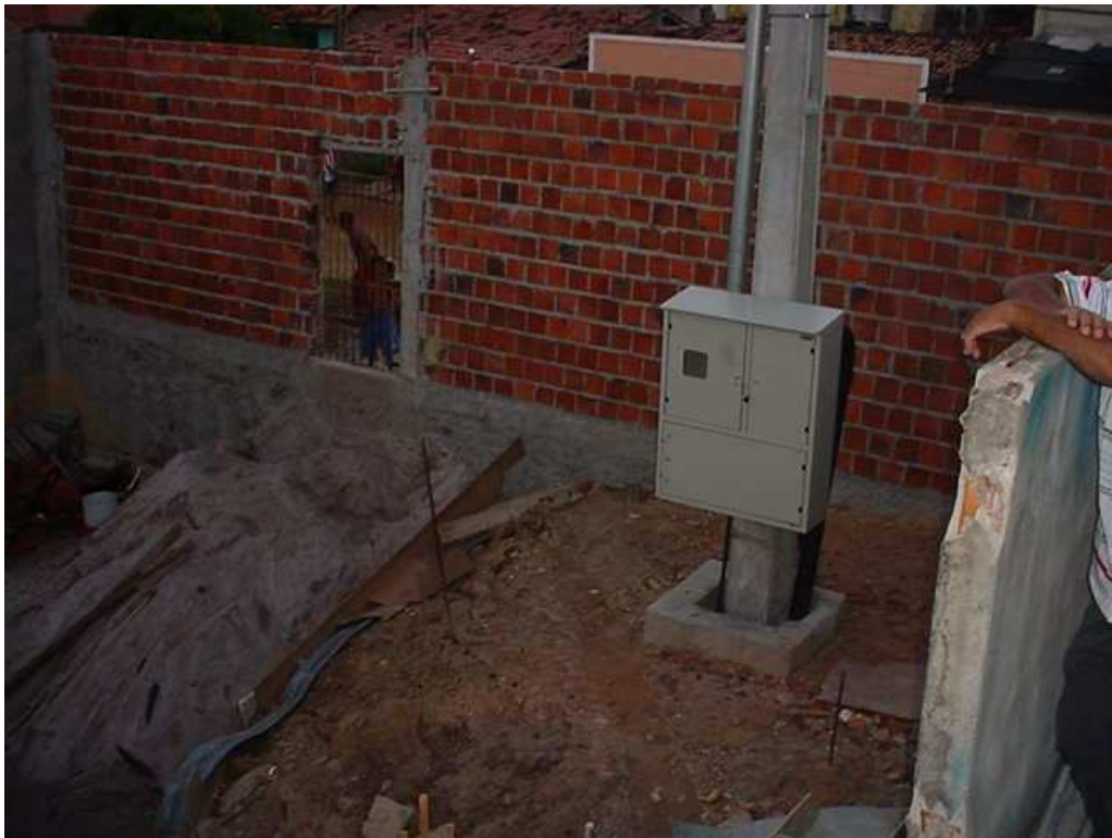
Quadro de força
