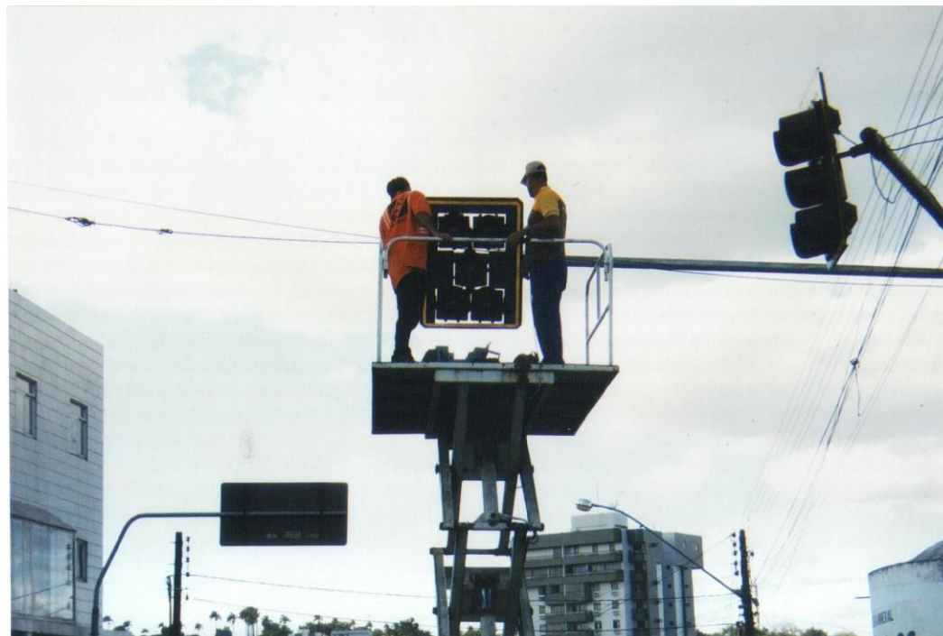
Figuras 18, 19 e 20 – Instalação de uma nova fase e um novo grupo focal na Av. Melo Leitão com a Av. Floriano Peixoto.
