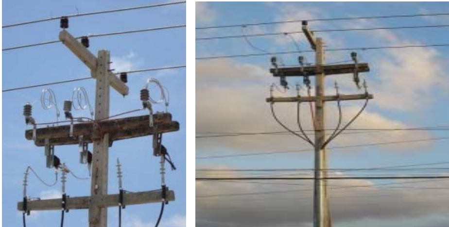
Figura 5.3 – Poste do ponto de derivação da rede primária.
