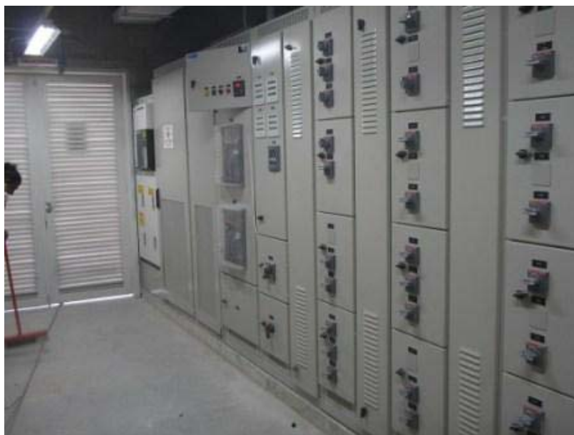
Figura 5.7 – Vista completa dos equipamentos da subestação.
