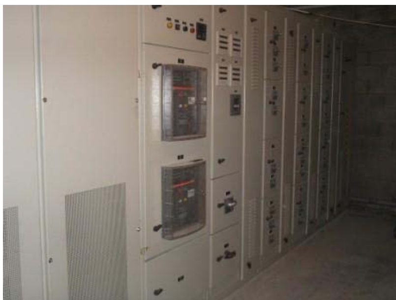
Figura 5.8 – Subestação vista por outro ângulo.
