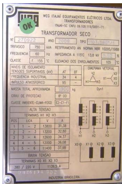
Figura 5.9 – Placa do transformador seco trifásico 750 kVA.
