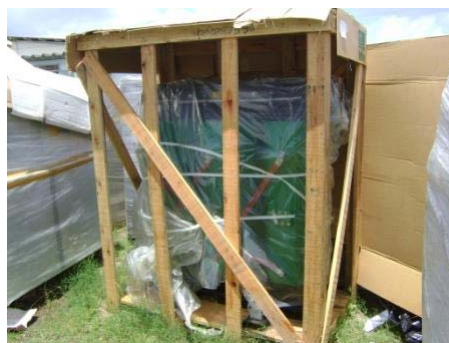
Figura 5.1 – Transformador Seco de 750 kVA
