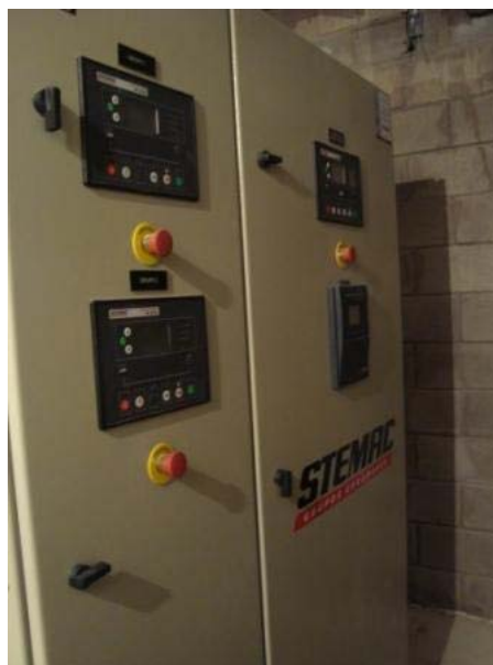
Figura 5.13 – Unidade de Supervisão de Corrente Alternada (USCA).
