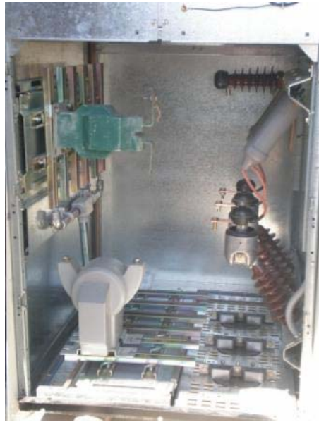
Figura 5.5 – Visualização da parte interna da cabine primária (TP em baixo e TC instalado na parte lateral).
