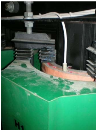
Figura 5.10 – Detalhe do enrolamento de baixa com um dos sensores do relé de temperatura.
