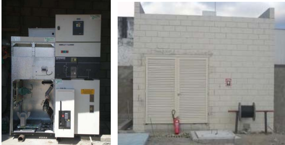
Figura 5.4 – Cabine Primária (esquerda) e o abrigo onde está alojada (direita).
