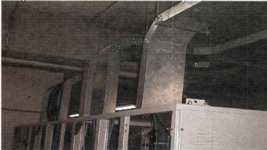
Figura 5 – Eletrocalhas de distribuição
