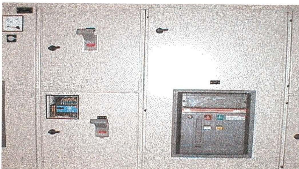
Figura 4 – Parte do painel do QGBT e do QGBTE
