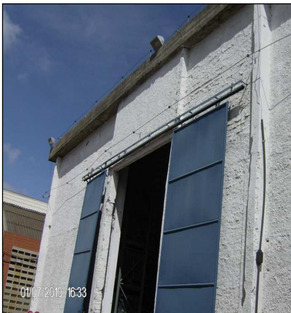
Figura A9 – Cabos de Descidas Instalados Próximo a Portas
