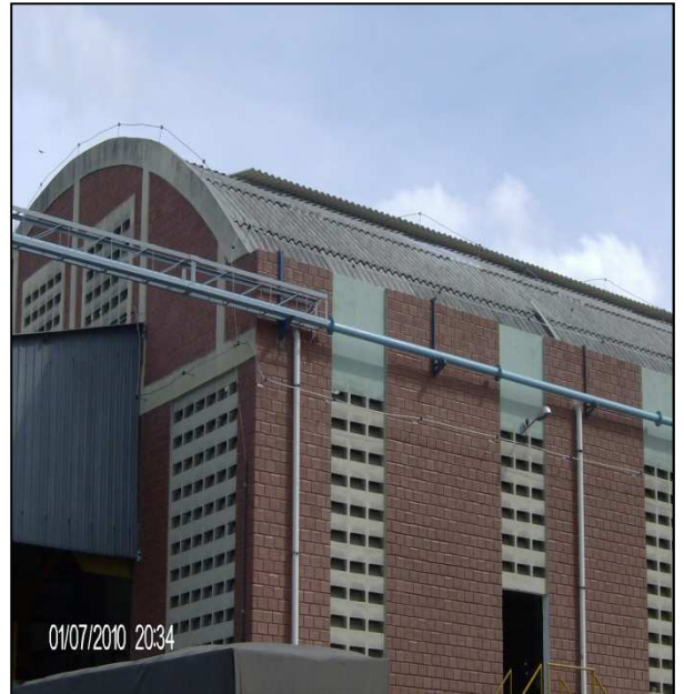
Figura A3 – Gaiola de Faraday aplicado ao Galpão da UGB 02/03
