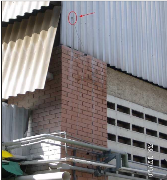
Figura A1 – Utilização da Parte Metálica do Galpão da UBG 01 como descida
