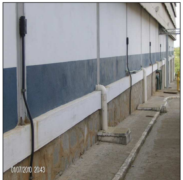
Figura A4 – Utilização das Ferragens das Armações internas do Galpão do Almoarifado como Descidas
