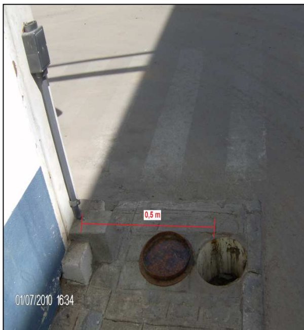
Figura A10 – Eletrodo de Aterramento Próximo as fundações da Estrutura
