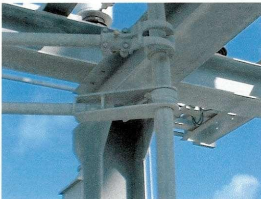
Figura 31 Chave seccionadora e chave de terra
