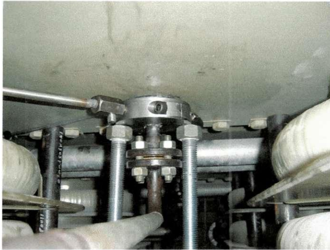
Figura 34 - Vazamento de H 2 do Gerador
