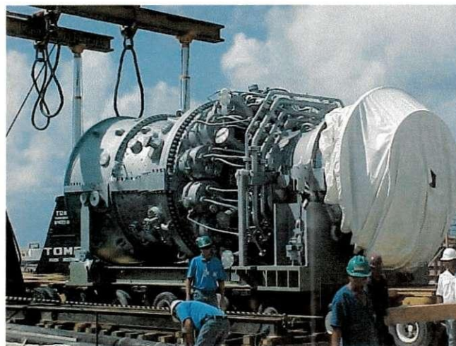
Figura 10 - Turbina a Gás
