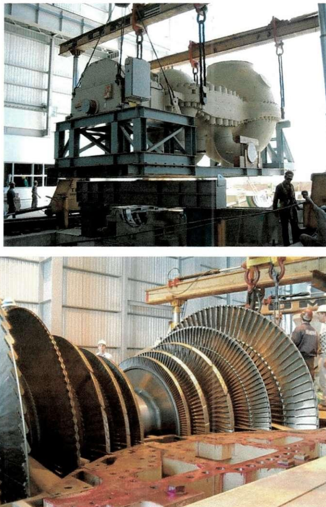
Figura 15 - Turbina a vapor
