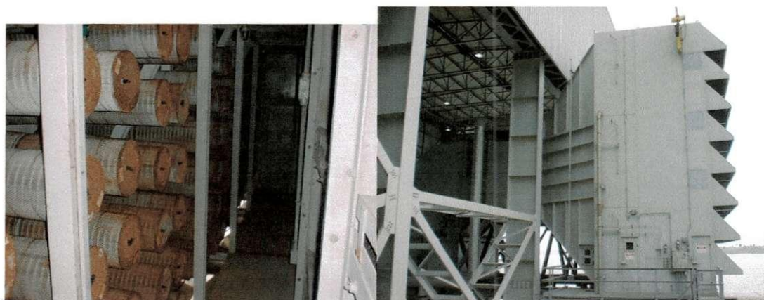
Figura 33 - Casa de filtro da admissão da turbina a gás
