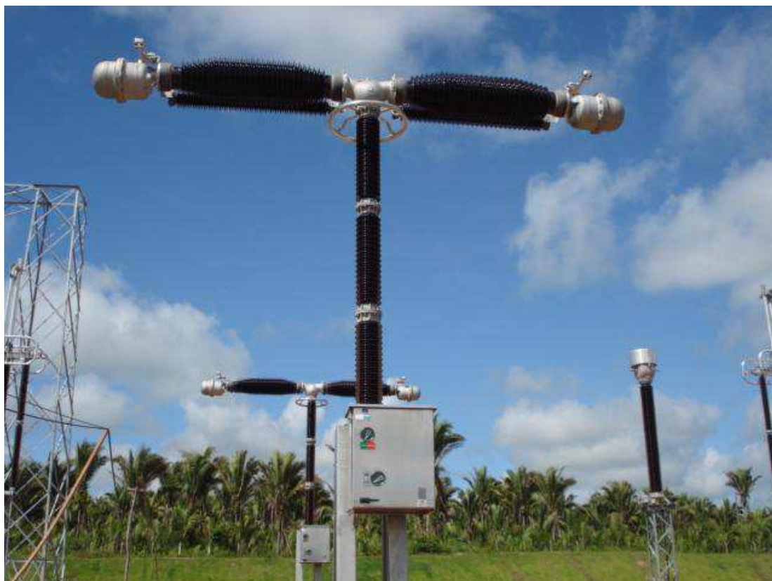
Figura 23: Disjuntor à SF 6 similar ao do acidente.
