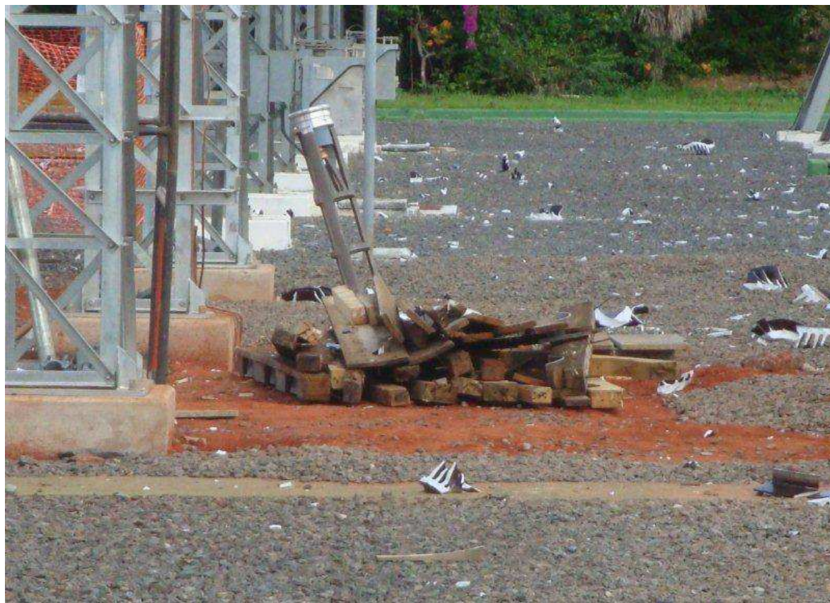
Figura 25: Estilhaços arremessados pela explosão.
