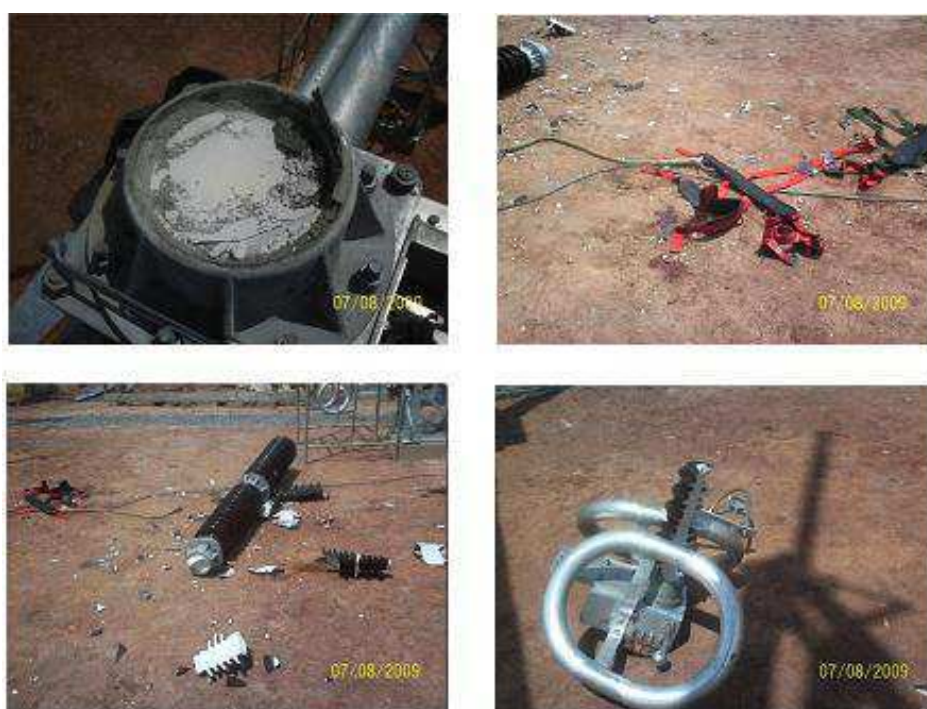
Figura 22: Chave Seccionadora após acidente.
