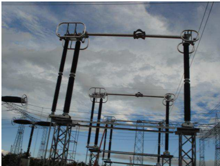
Figura 21: Chave Seccionadora similar à do acidente.
