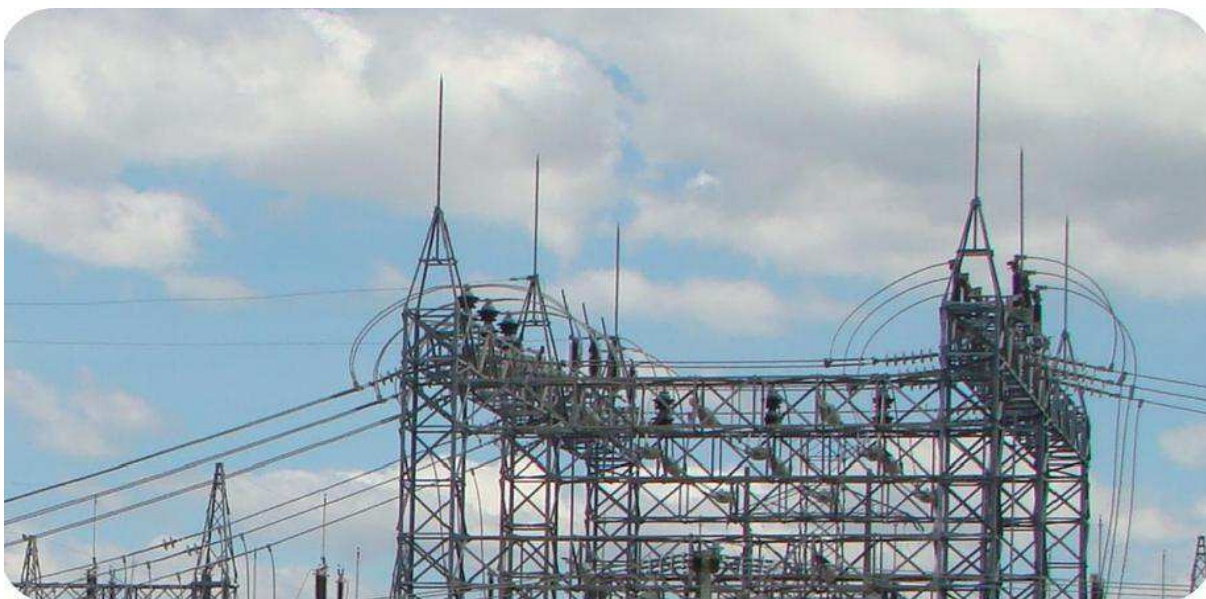
Figura 15: Captor Franklin em uma subestação.
