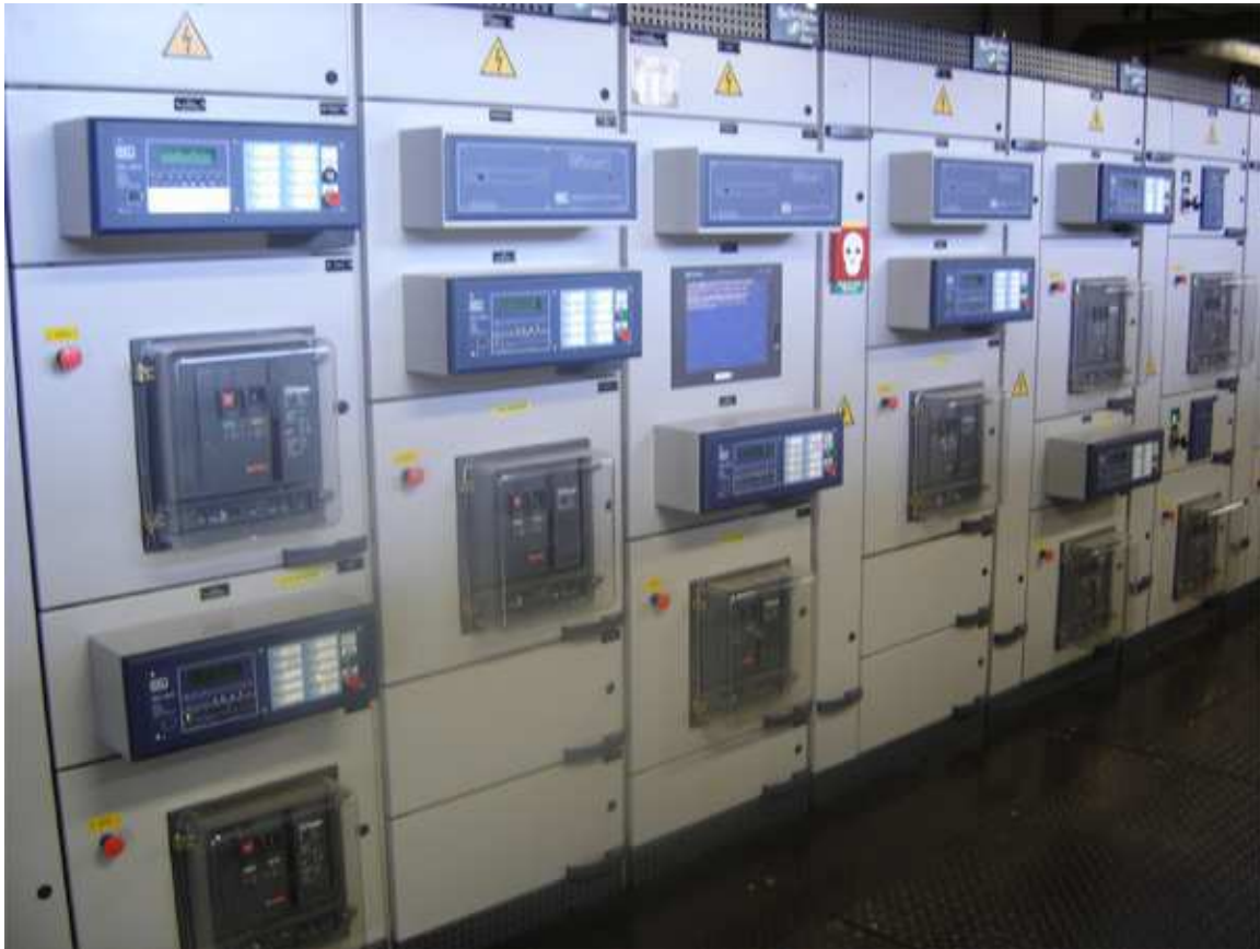
Figura 4.1: painel de controle de subestação com relés digitais modelo SEL-351S
