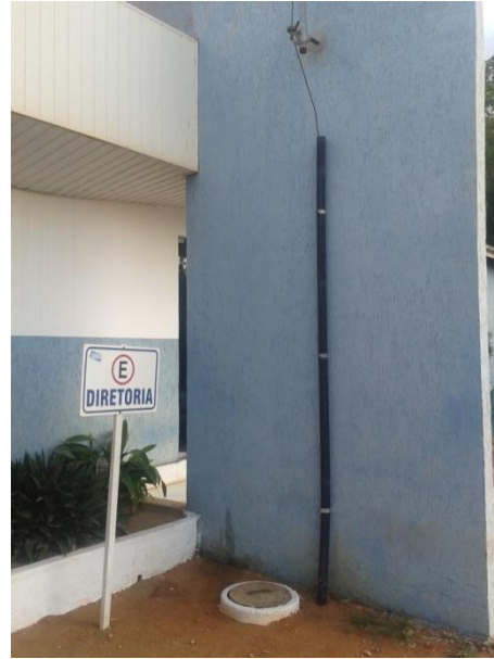
Figura 10 Detalhes: Cabo de Aterramento, Braçadeira, Abraçadeiras Tipo-D e Poço de Aterramento.
