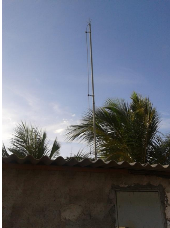
Figura 16 Para-Raios Instalado no Apoio para Encarregados
