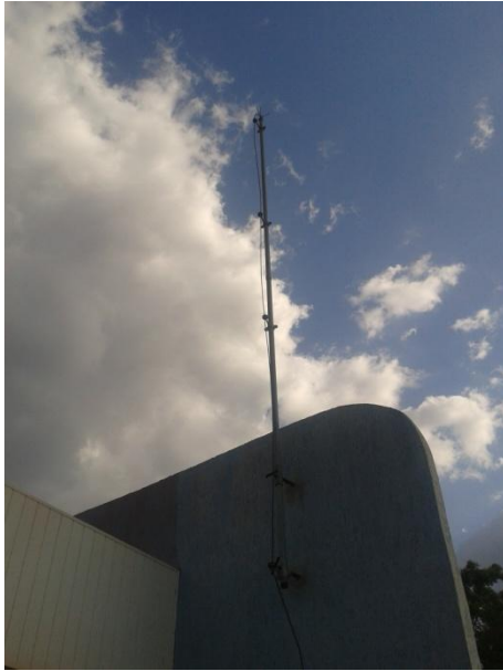
Figura 9 Para-Raios Instalado no Setor Administrativo.
