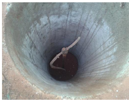
Figura 21 Detalhe do poço de inspeção do aterramento do SPDA.
