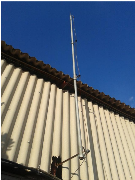
Figura 14 Para-Raios Instalado no Almoxarifado.
