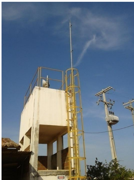
Figura 12 Para-Raios Instalado na Caixa D'água
