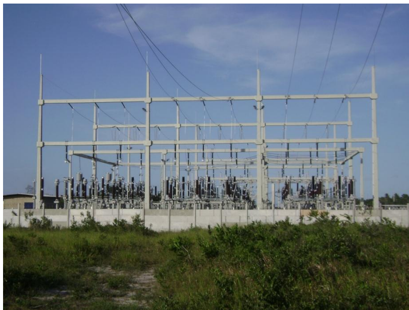
Figura 19. Fotografia da subestação de Santa Rita II.
