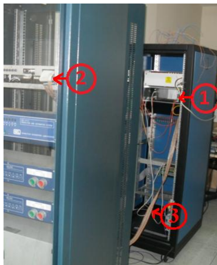
Figura 3.46 – Conexão do relé ao RTDS™ via Cabo Flat.
