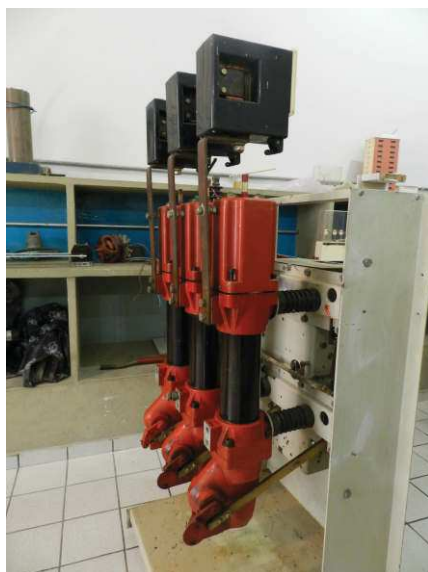
(a) Disjuntor D1.
