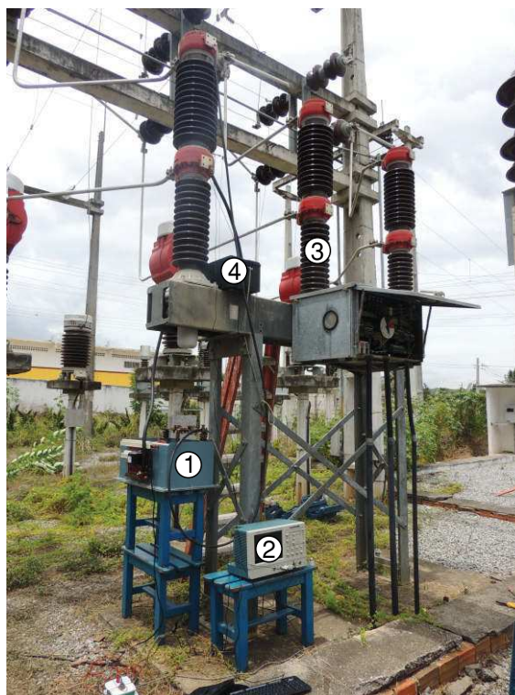
Figura 4.12 – Fotografia do arranjo montado em subestação para os ensaios da MRD no disjuntor D4.
