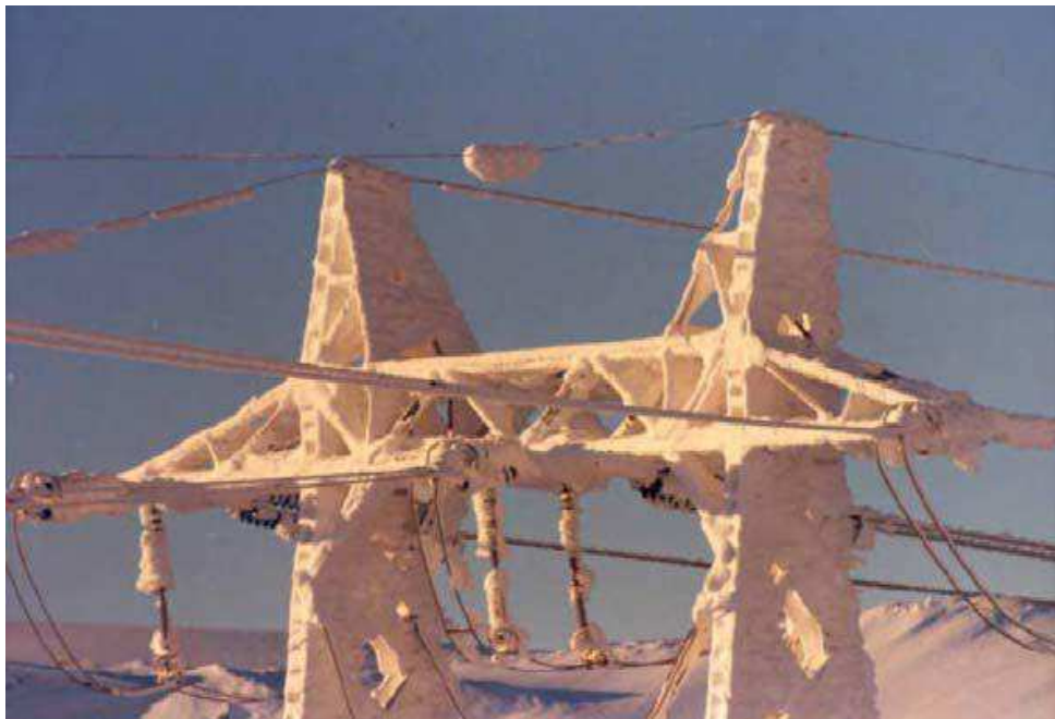
Figura 2.3 - Torre de transmissão atingida por tempestade de neve, no Canadá, 1998.
