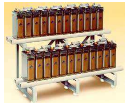
Figura 4: Foto de banco de baterias ventiladas.
