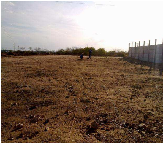
Figura 5-3 - Fotografia da medição de Resistência de aterramento
