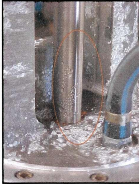
FIGURA 29 – Visível contaminação com água no guia.
