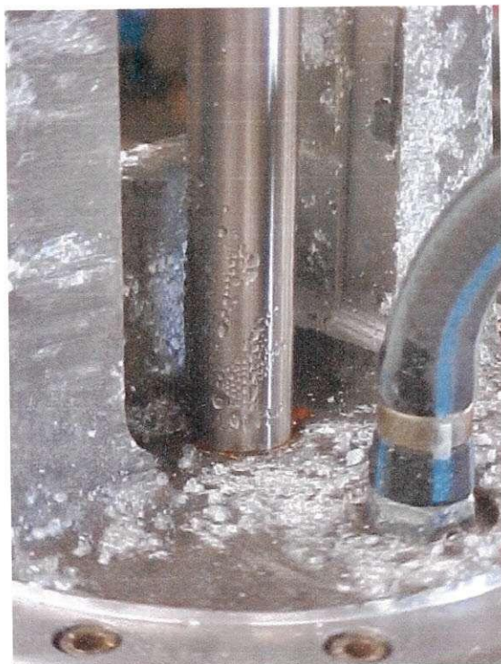
FIGURA 32 – Braçadeira da mangueira de gás oxidada.
