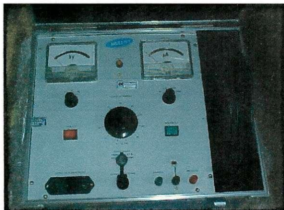
FIGURA 49 - Equipamento Destinado a Medição de Isolação em Cabos de Alta Tensão.
