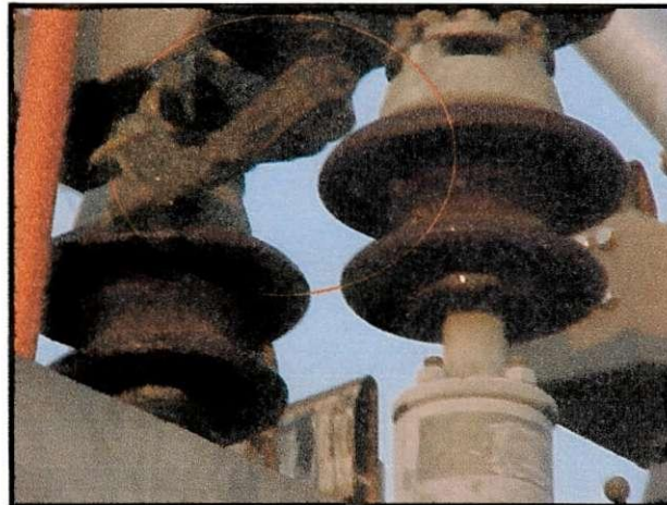
FIGURA 10 – Chave seccionadora com parte rompida
