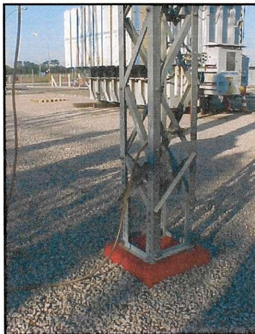
FIGURA 14 – Cabo de aterramento par a segurança da operação.
