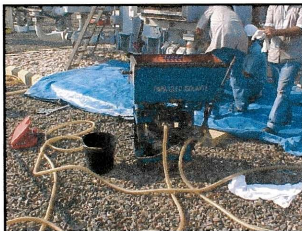
FIGURA 08 – Máquina filtro/bombedora de óleo isolante
