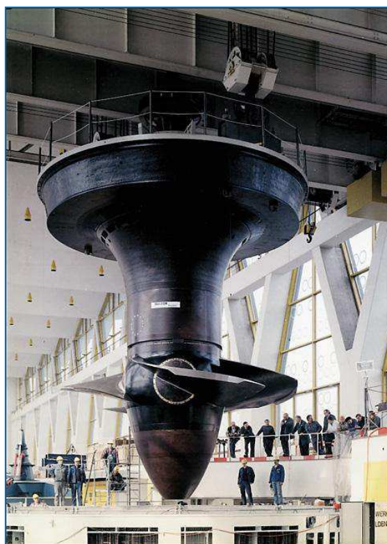
FIGURA 12 - TURBINA KAPLAN FONTE: TECNOLOGIA.ORG, 2011
