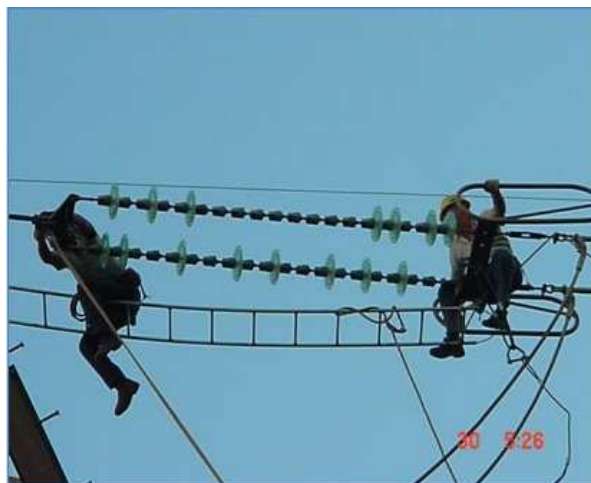
Figura 2.21. Manutenção em cadeia de isoladores danificada.
