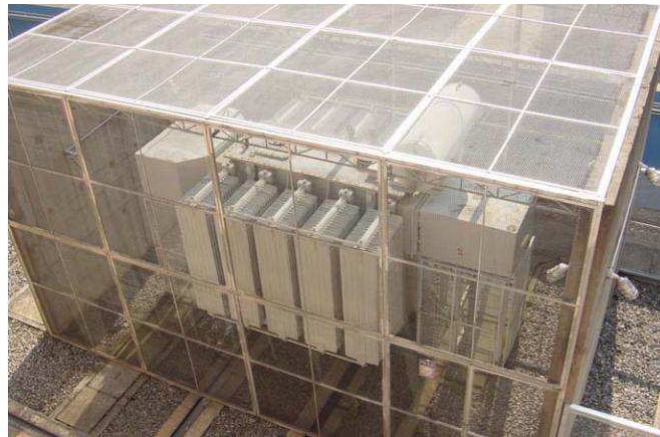
Figura 6 - Transformador sendo protegido por uma barreira.
