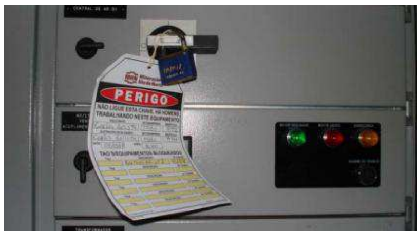
Figura 7 – Bloqueio de um quadro elétrico.
