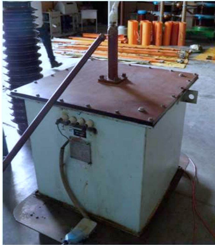
Figura 13. Transformador para ensaios de propriedade do LAT-UFCG.
