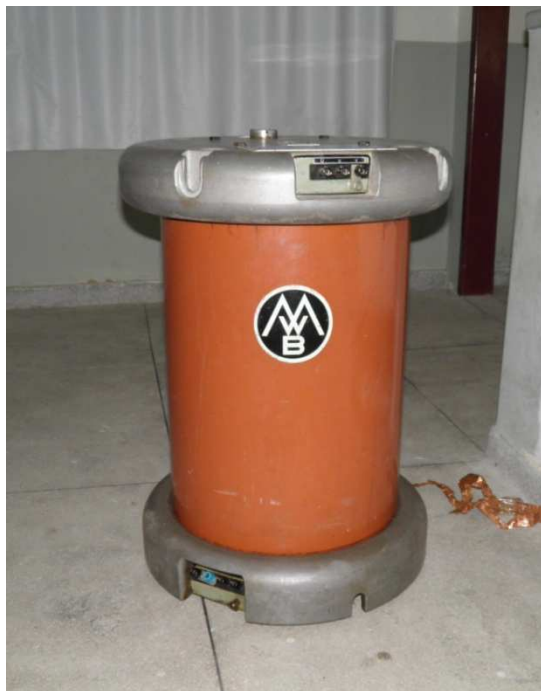
Figura 16. Transformador para ensaios com carcaça isolante e tampa metálica de propriedade do LAT-UFCG.
