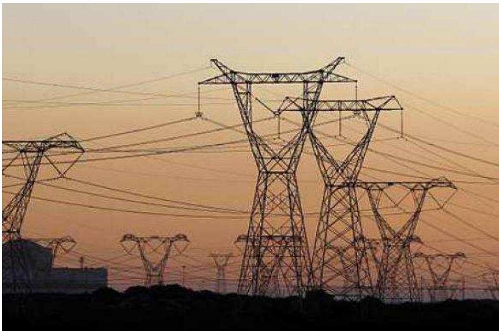
Figura 2.2. Foto ilustrativa de torres de transmissão.
