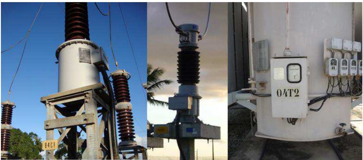
Figura 2.4. Equipamentos de transformação.
