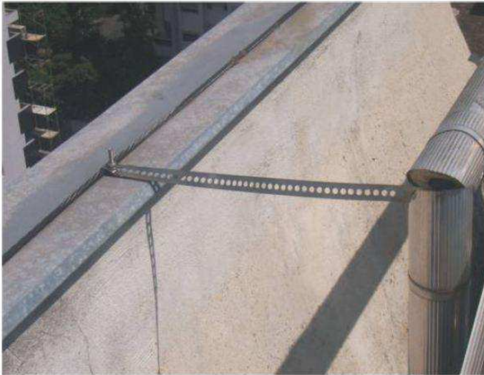
Figura 20. Fita perfurada para equipotencialização.
