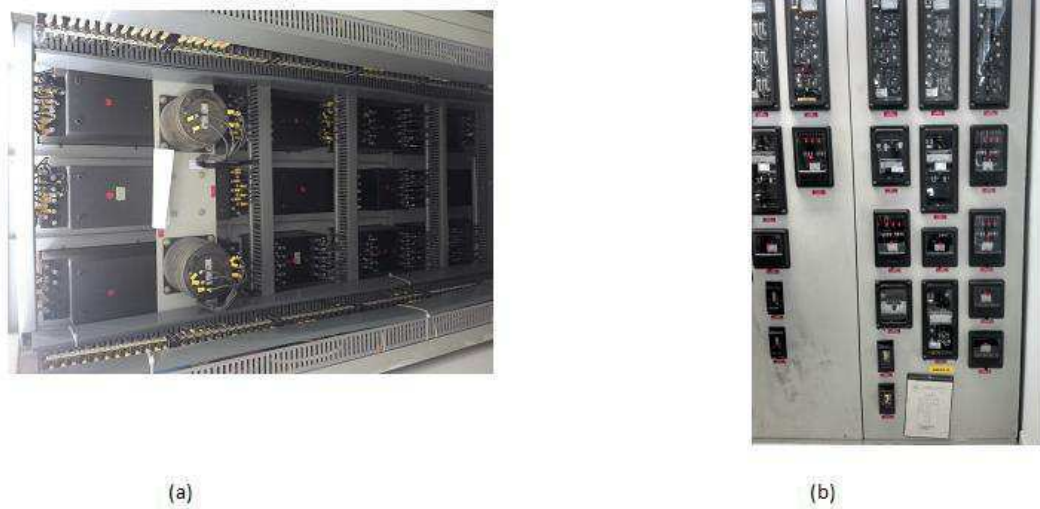
Figura 17 painel de proteção usando relés eletromecânicos, (a): vista traseira e (b): vista frontal
