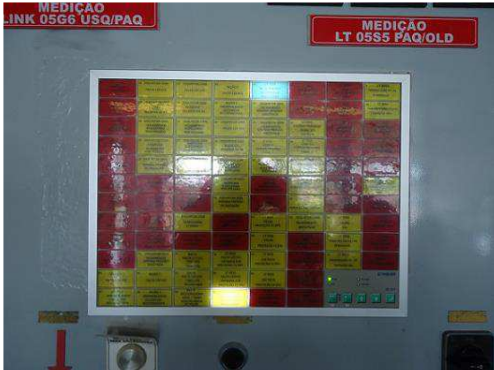
Figura 21 quadro anunciador do vão G da subestação SE-PAQ
