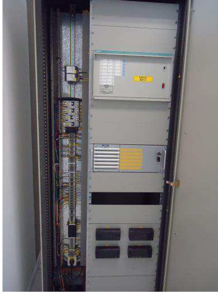
Figura 23 Painél do Oscilógrafo do vão G da subestação SE-PAQ
