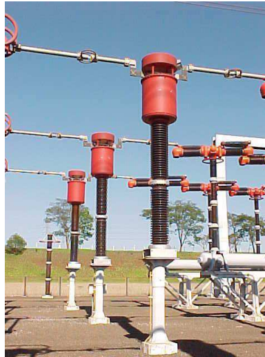
Figura 3 Transformador de Corrente tipo Barra
