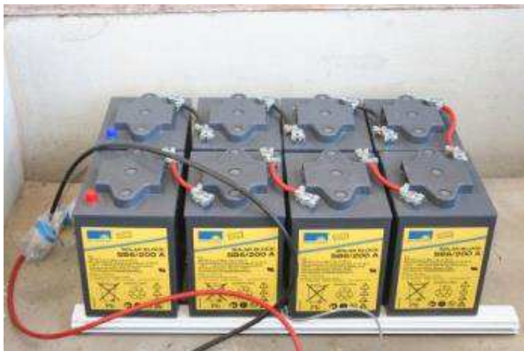
Figura 4.8. Banco de baterias solares constituído por 8 blocos de 6V, 200Ah. [31]
