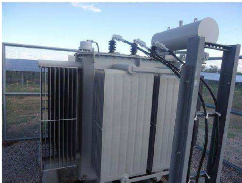
Figura 5.12. Transformador Elevador ZILMER - 1250 kVA - 220 V / 13,8 kV. [36]
