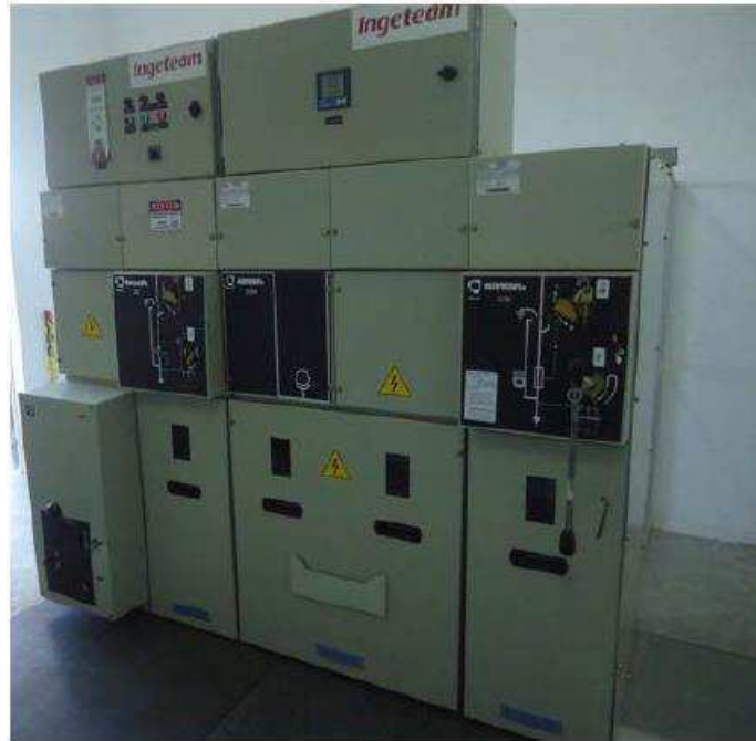
Figura 5.13. Cubículo de Média Tensão da fabricante EFACEC, montado pela INGETEAM. [36]
