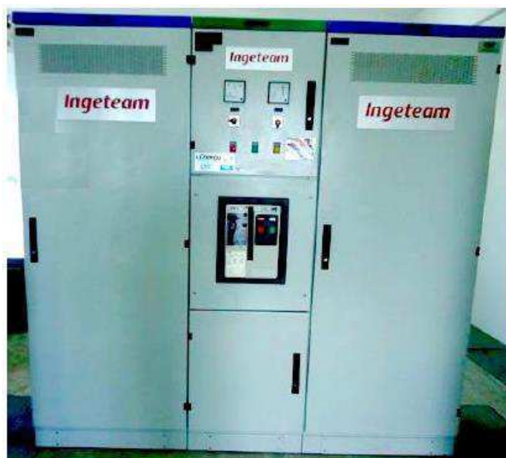
Figura 5.10. Quadro Geral de Baixa Tensão (QGBT) instalado na usina. [36]
