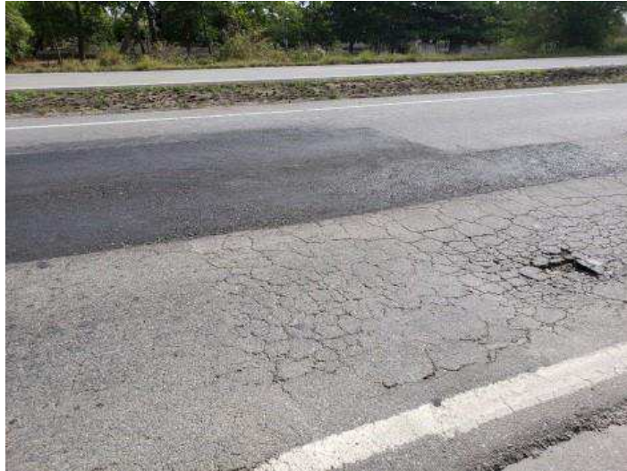
Figura 72 - Defeitos observados na rodovia BR-230/PB – Painelas e trincas interligadas
