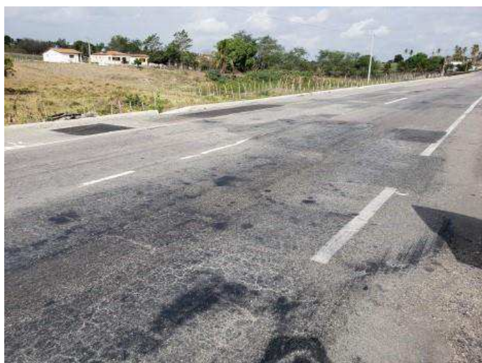
Figura 71 - Defeitos observados na rodovia BR-230/PB – Exsudação e remendos
