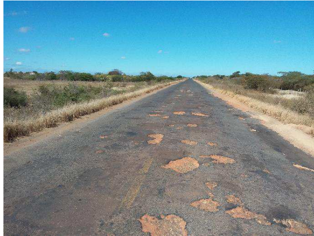
Figura 9 - Pavimento com ocorrência de panelas ou buracos
