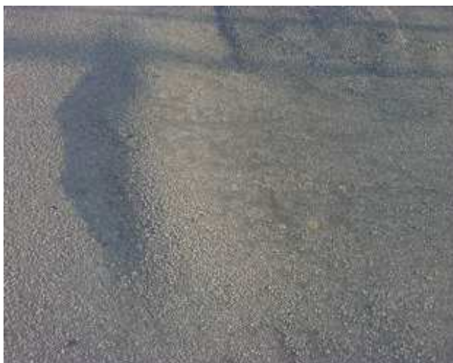
Figura 6 - Ondulação ou corrugação em superfície de pavimento
