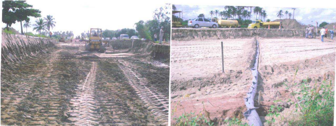
Figura 36 - Implantação do colchão de areia (a) e do selo de argila (b)
