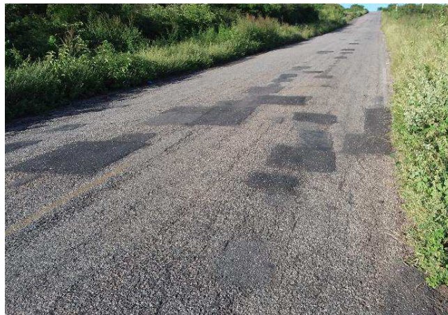
Figura 10 - Remendos na superfície do pavimento.
