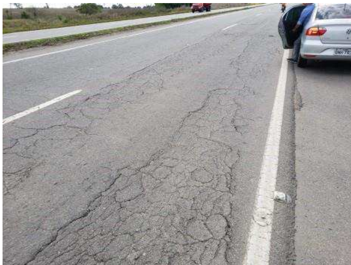
Figura 70 - Defeitos observados na rodovia BR-230/PB – Trincas FC-2 e FC-3
