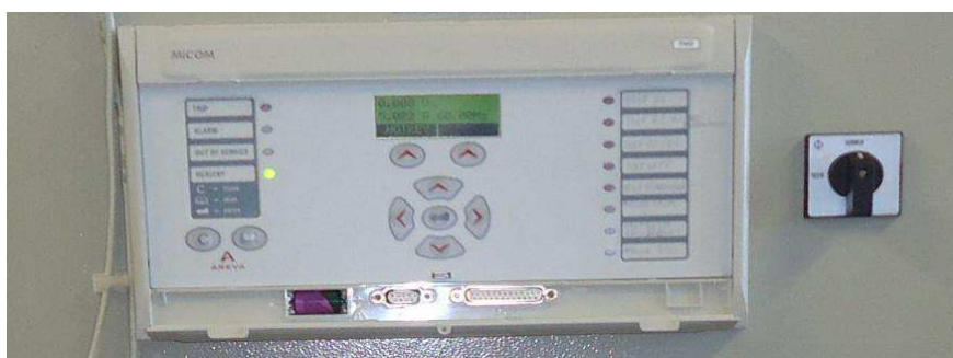
Figura 9. Parte frontal do relé P442 Alstom.
