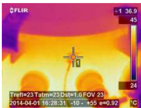
Figura 17. Inspeção termográfica quando da chegada ao regime térmico.
