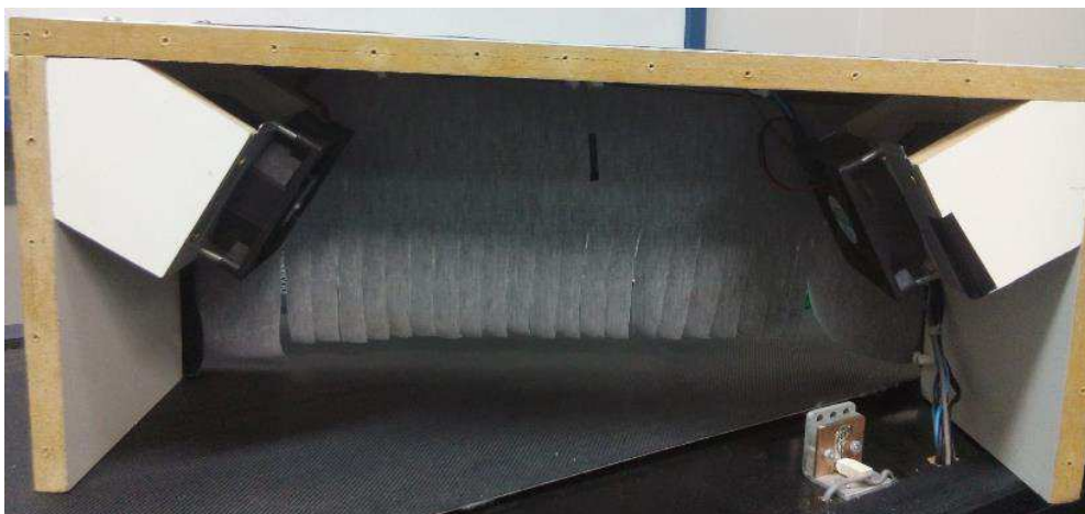
Figura 22: Interior do Módulo de Aquecimento.
