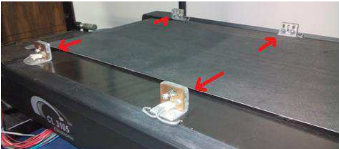
Figura 18: Sensor óptico de barreira instalado na esteira transportadora.
