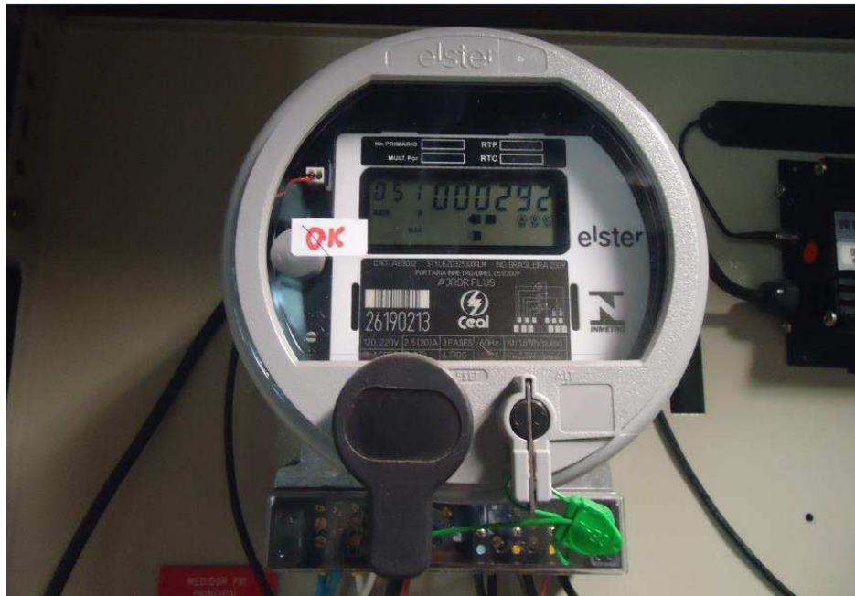
FIGURA 18: MEDIDOR DE ENERGIA
