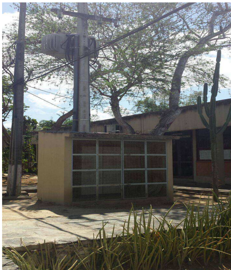
Figura 21. Ponto de instalação do medidor SEL-735 no DEE. [Fonte: Rayan Barreto]
