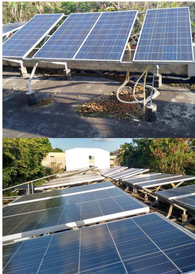
Figura 8. Conjuntos de painéis fotovoltaicos. [Fonte: Rayan Barreto]
