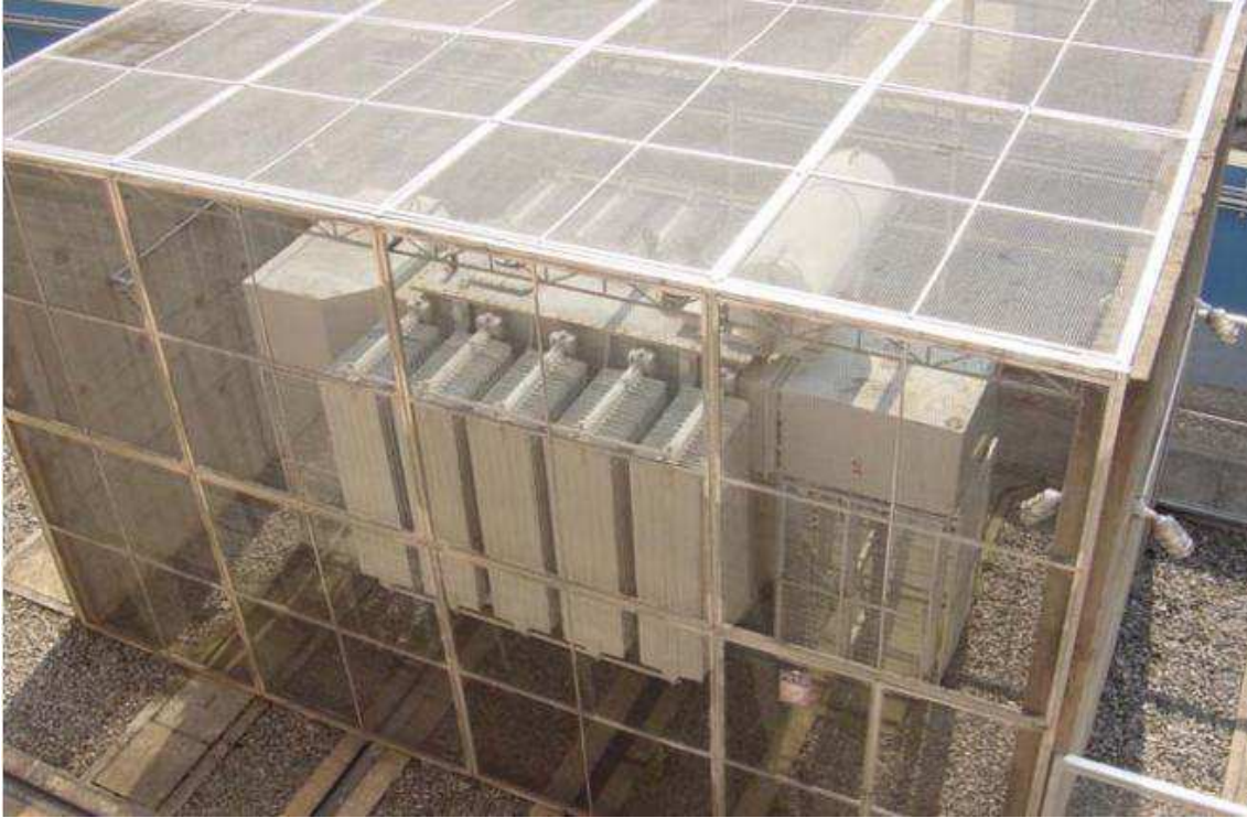
Figura 8 – Transformador sendo protegido por uma barreira.
