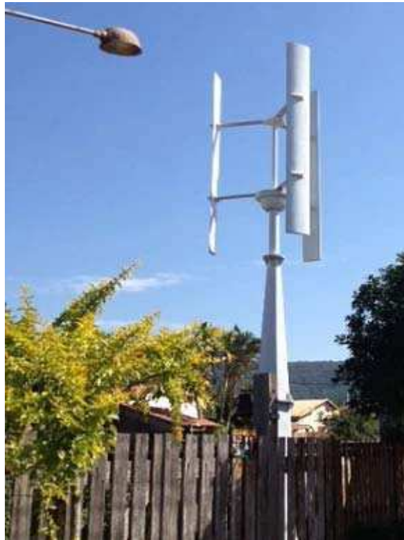
Figura 15 - Aerogerador de Eixo Vertical
