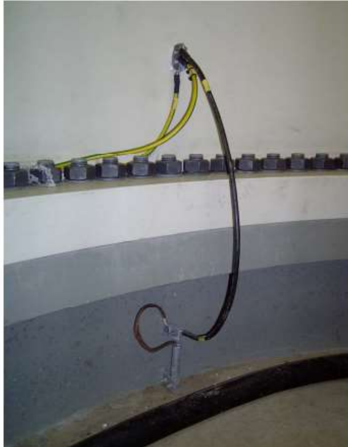
Figura 31 - Conexão entre os cabos de descida e o sistema de aterramento
