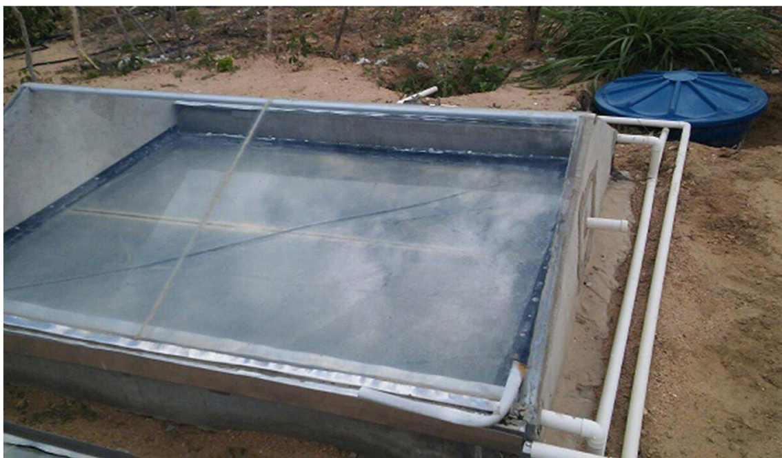
Figura 20: Coletores de alumínio conectados aos canos de PVC para escoamento das águas das chuvas para um reservatório (caixa de PVC de 310 litros).
